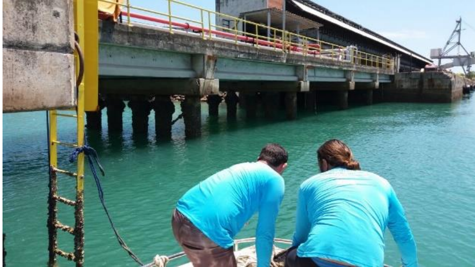
figura 1 localização de um dos pontos de ancoragem das placas no terminal de graneis líquidos
